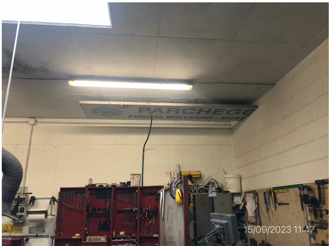
Foto 3: infiltrazioni acqua in officina
