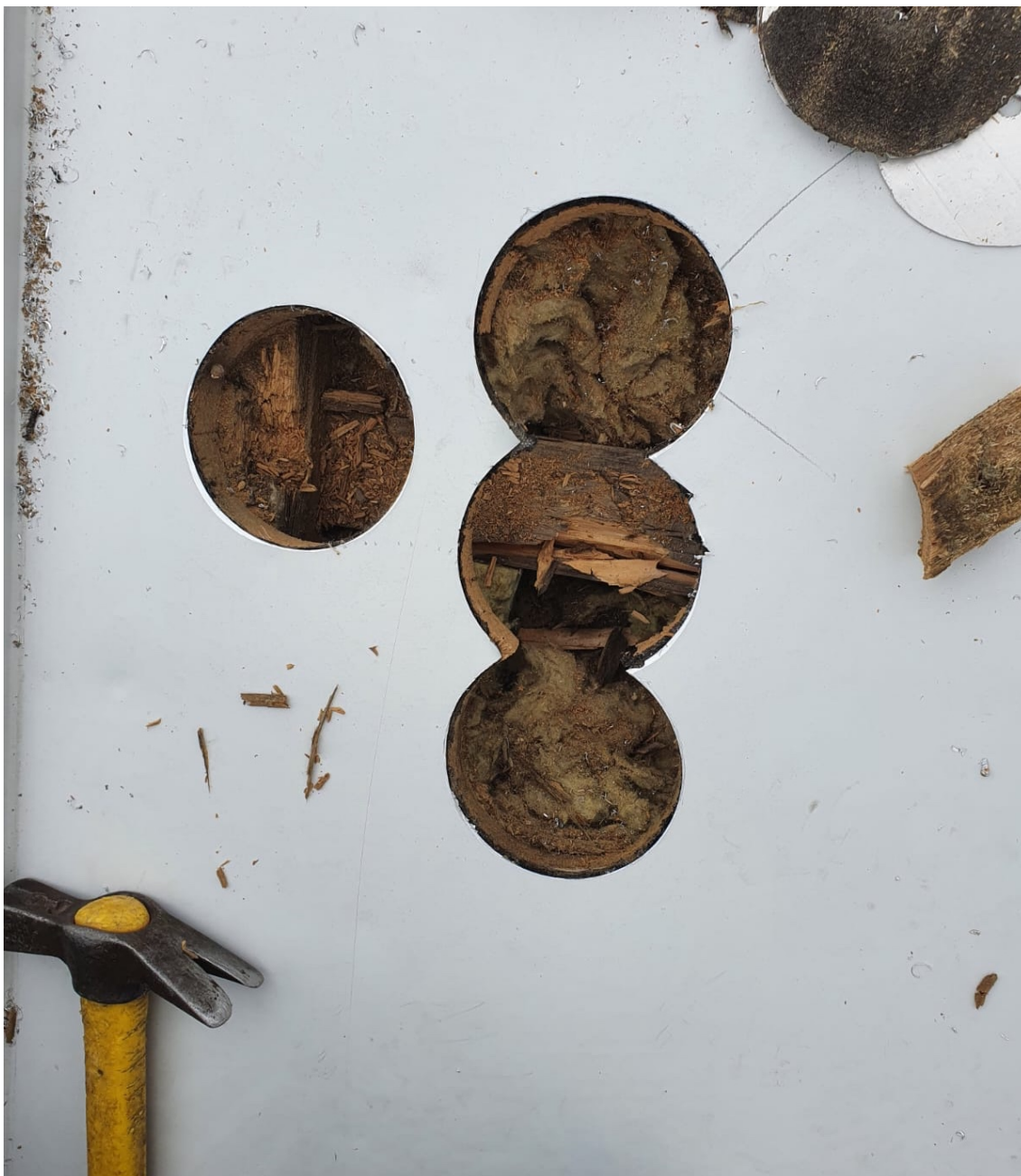
Foto 9: sondaggi copertura, si noti il degrado del pacchetto
