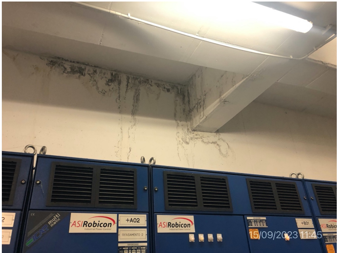
Foto 2: infiltrazioni d'acqua sopra i quadri elettrici
