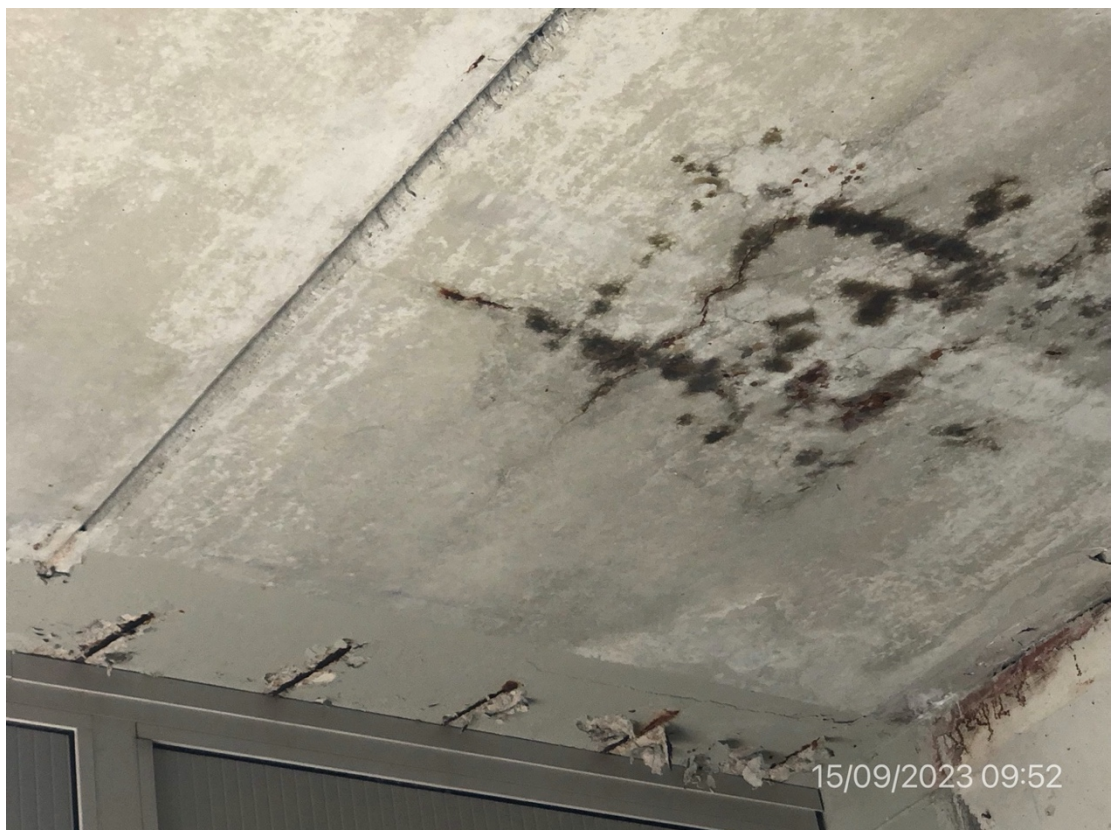
Foto 8: armature in vista e infiltrazioni
