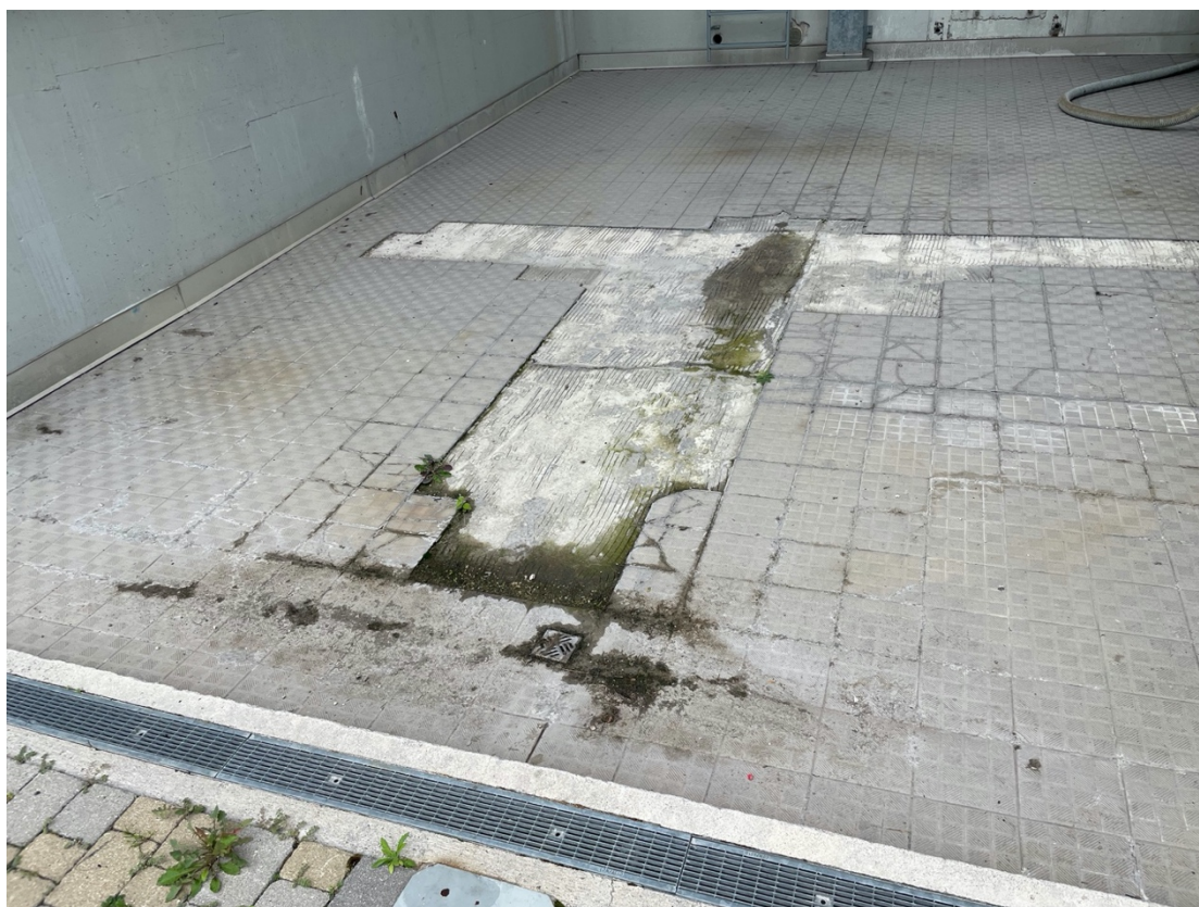
Foto 1: pavimento in piastrelle danneggiato
